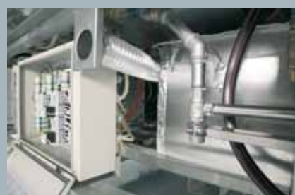
Vano tecnico per allacciamenti
